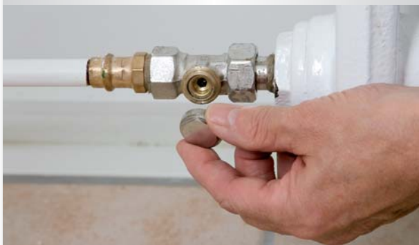
Prüfen der Voreinstellung an einer Rücklaufverschraubung
