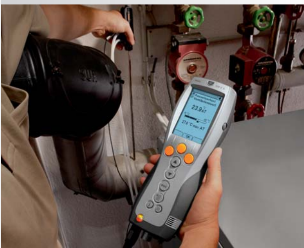
Messung der Strömungsgeschwindigkeit in der Abgasleitung
