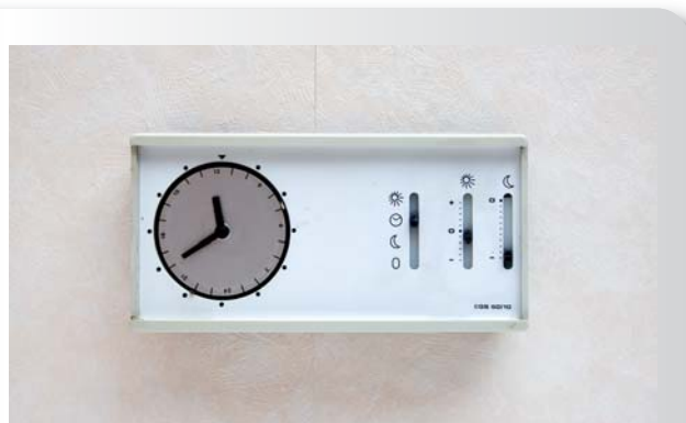
Raumgeführte Regeleinrichtung mit Nachtabsenkung
